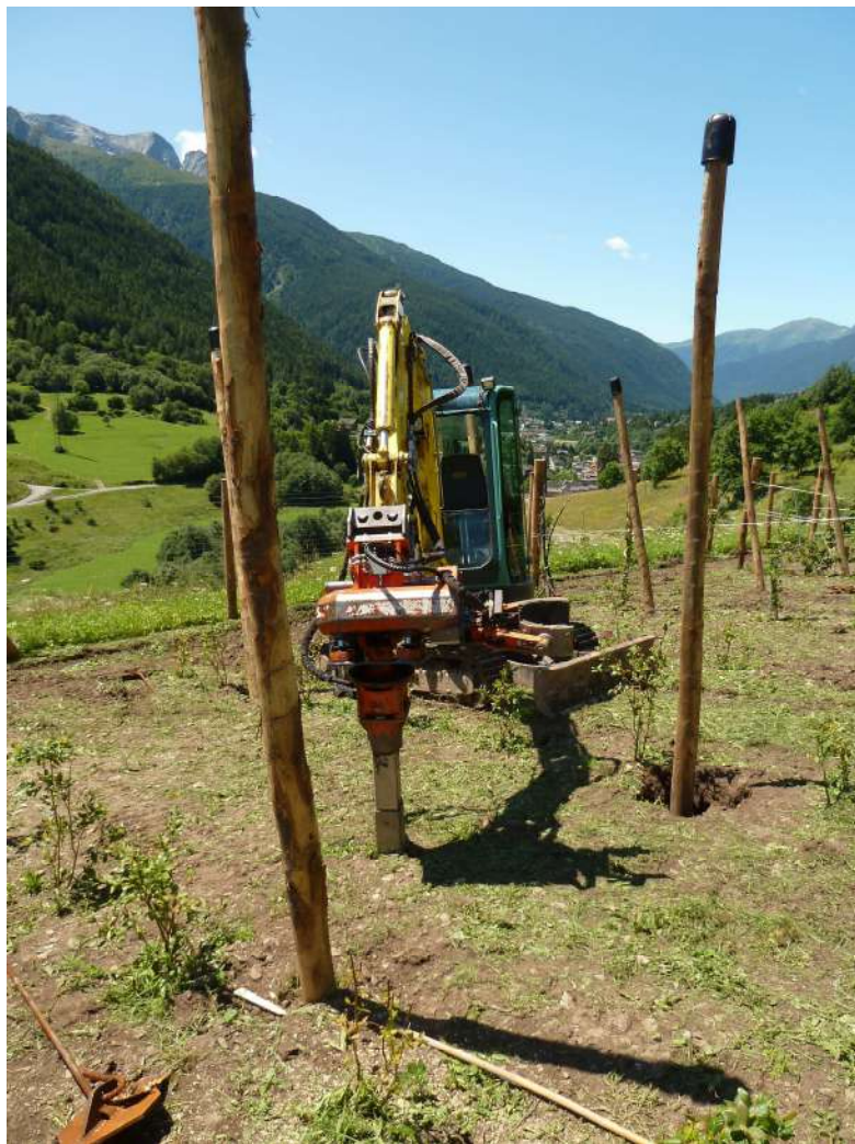
Realizzazione di struttura di sostegno e copertura coltivazione in legno di castagno
