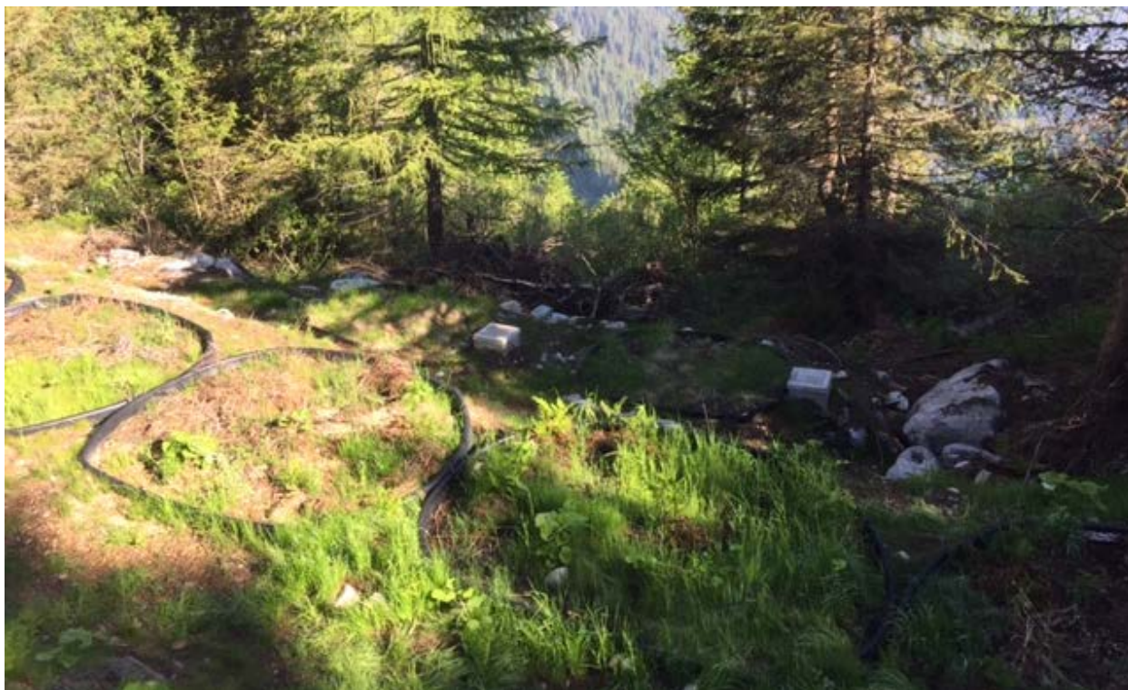
FIGURA 8 - IMPIANTO A SERVIZIO DEL RIFUGIO AVIOLO - GIUGNO 2016
