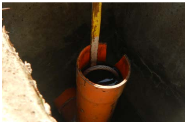
PARTICOLARE DEL TUBO DI REGOLAZIONE DELLE PRIME 5 VASCHE DELLA LINEA 2
