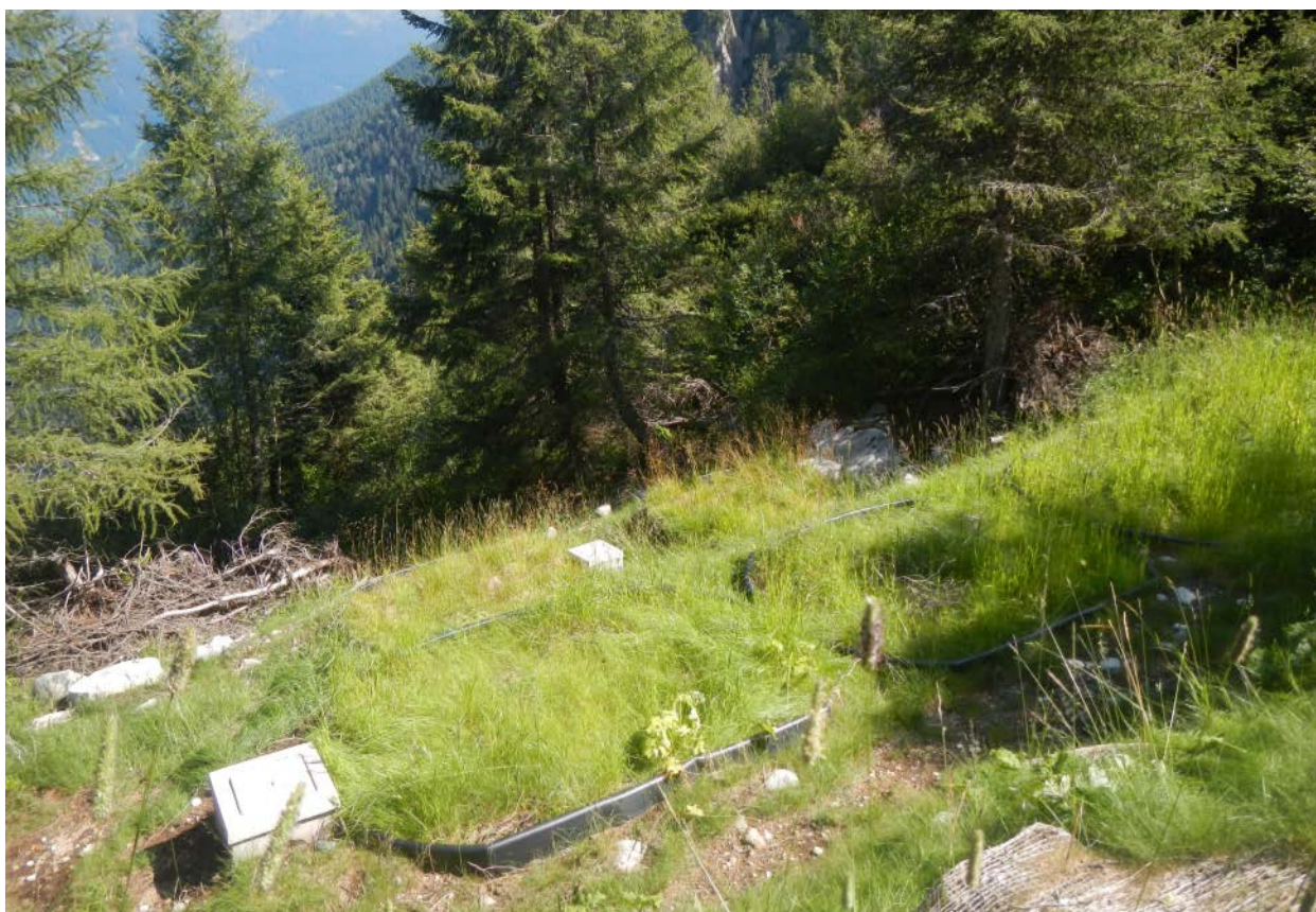
FIGURA 9 - IMPIANTO A SERVIZIO DEL RIFUGIO AVIOLO - LUGLIO 2017
