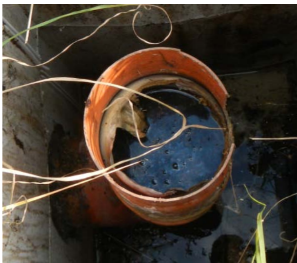
PARTICOLARE DEL SISTEMA DI REGOLAZIONE A VALLE DEL PRIMO LETTO
