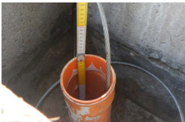
PARTICOLARE DEL TUBO DI REGOLAZIONE DELLE PRIME 5 VASCHE DELLA LINEA 1
