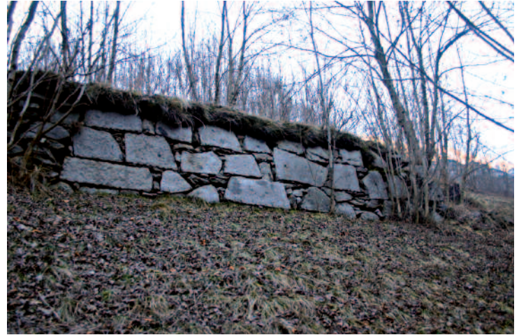
Le radici degli alberi, sebbene da giovani contribuiscano a trattenere le pietre, a maturità possono generare spinte tali da compromettere la stabilità del muro e causarne il crollo in prossimità della pianta
