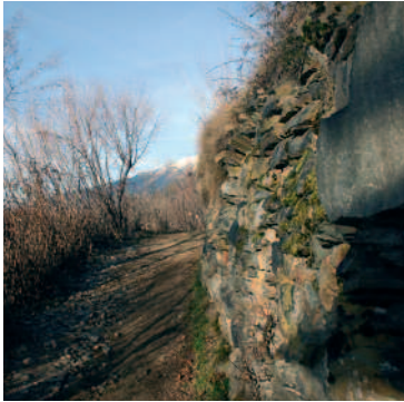
Crollo di porzione di muro
