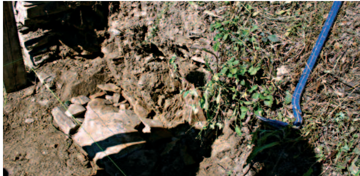
Per la realizzazione delle fondazioni le pietre di grandi dimensioni vanno collocate sul fondo; per lo spostamento di tali pietre si può utilizzare una leva (in azzurro nella foto)
