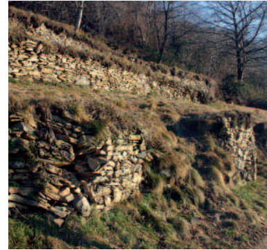
Crollo di parte di muro
