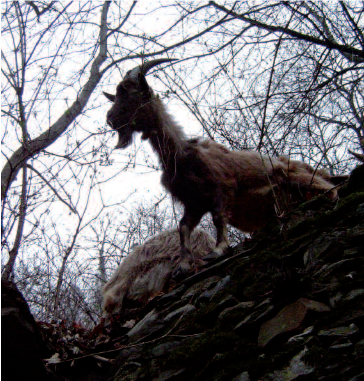
L'arrampicamento degli animali sui muretti può causarne il crollo: in questo caso una capra si sporge sul colmo del muretto e ne provoca il progressivo sgretolamento del tetto di terra ed erba che lo consolida, iniziando il processo di degrado e perdita di elementi
